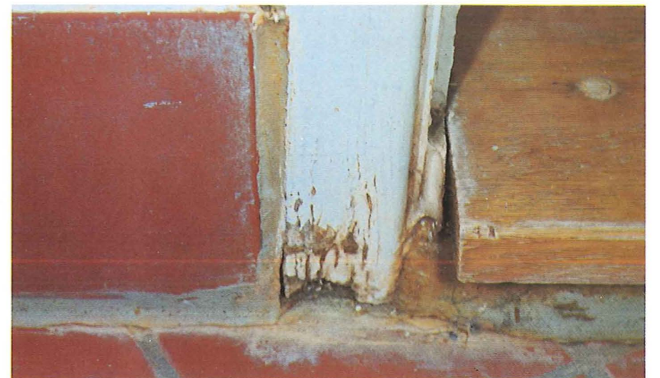
Begyndende nedbrydning i bygningsdel (omtalt side 19)
