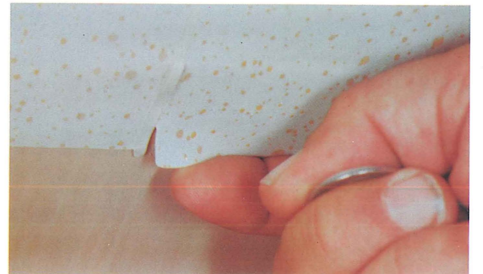
Manglende vedhæftning af pvc (omtalt side 18)
