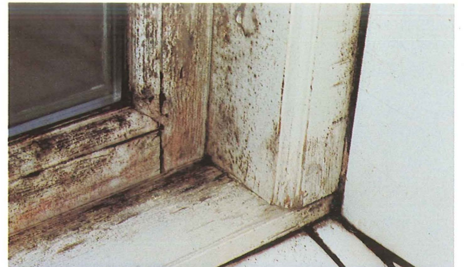
Fugtophobning i vindue (omtalt side 19)
