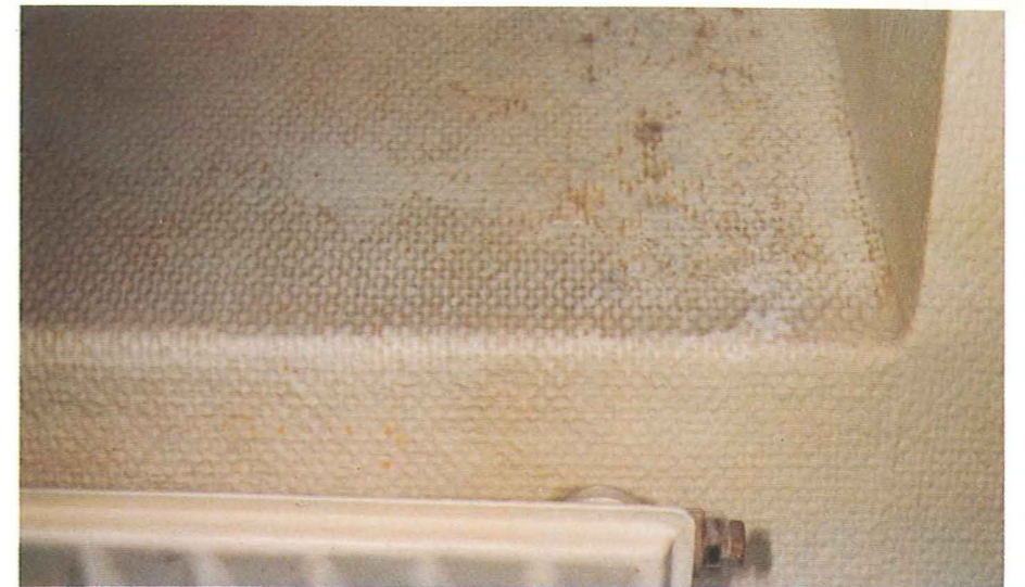
Fugtophobning i brystning (omtalt side 19)
