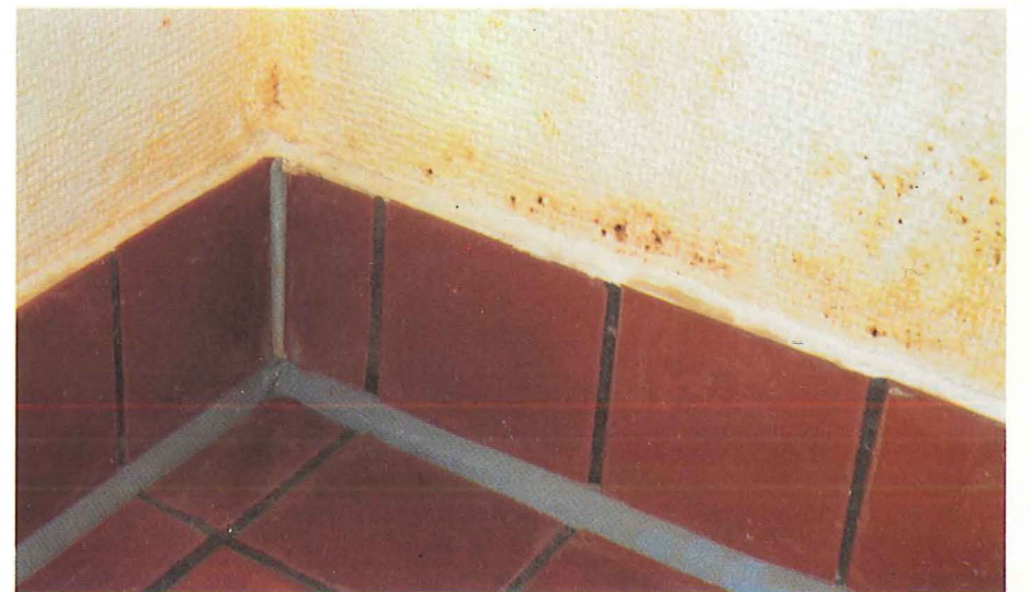
Fugtophobning i hjørner (omtalt side 18)
